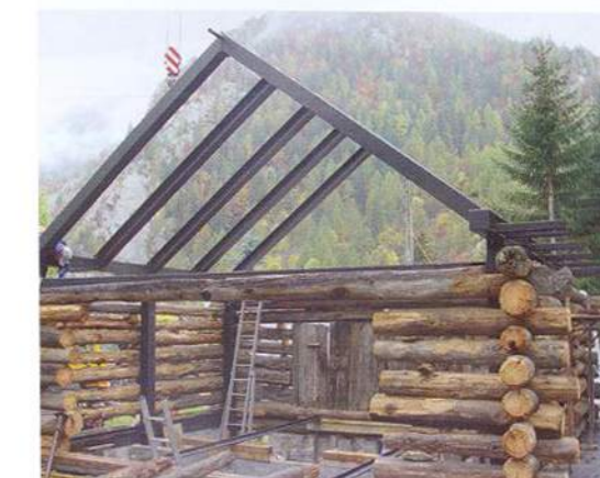
Die tragende Stahlstruktur ist aufgerichtet. Viene eretta la struttura portante in acciaio.
